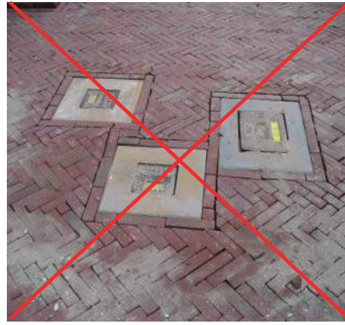
Putten in gebakken bestrating niet met betonrand om put besstraten maar middels gebakken klinkers voorbeeld links.
